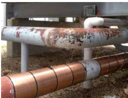
Vulcan S250安装在了一个给双冷却塔供水直径10英寸的管道上。 (CT-1 和 CT-2)
