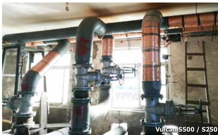
Vulcan S500 / S250 S500和S250分别安装在两个冷却水进水主管路上
