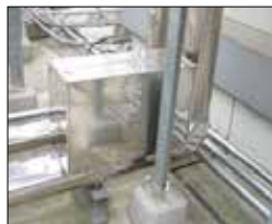
为处理流经冷却塔A、B和C的水
