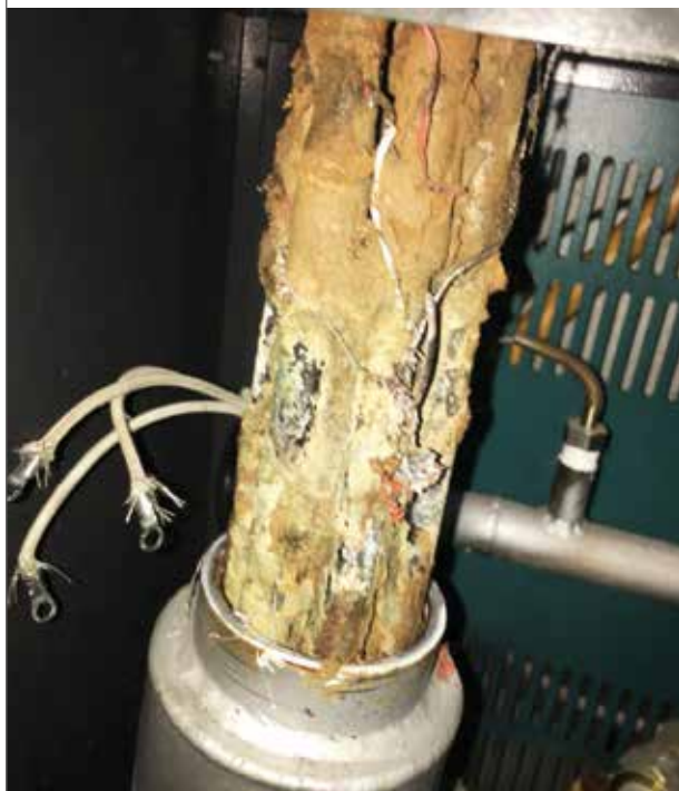
三年未作处理的换热器结垢情况
