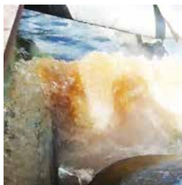
沃肯安装不到一个月，冷却水主管道开始排出锈水
