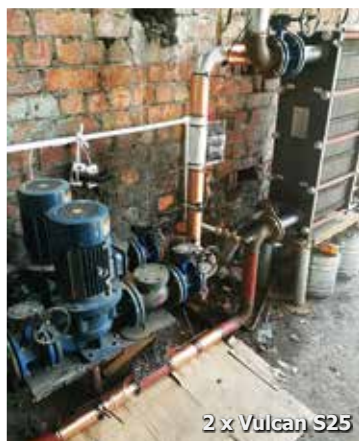
2 x Vulcan S25 两组S25安装在洗浴用的换热器两侧循环水管路上
