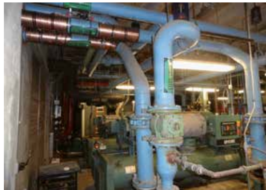
安装在双制冷机上的Vulcan S100装置
