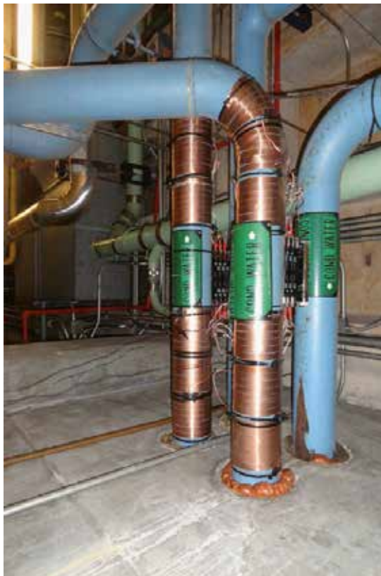
安装在双制冷机上的Vulcan S100装置
