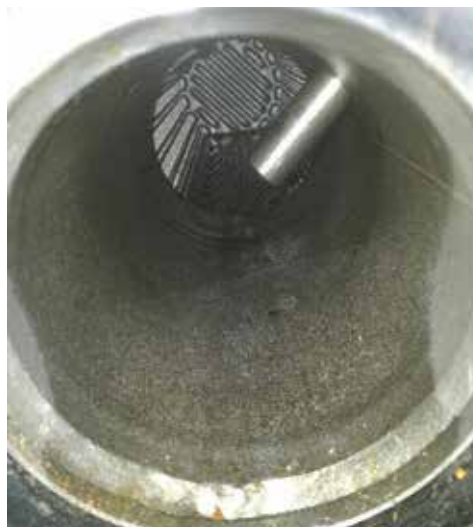
沃肯(Vulcan)安装三个月后 到目前为止, 安装的管道仍无需清洁
