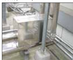
为处理流经冷却塔A、B和C的水
