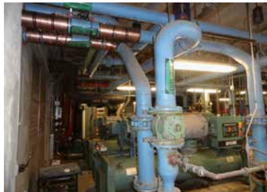
安装在双制冷机上的Vulcan S100装置
