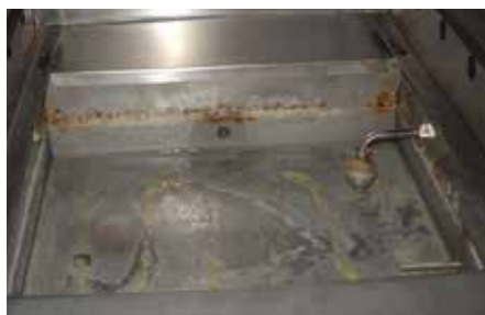
安装沃肯 (Vulcan) 之前 - 水锅里有硬垢堆积
