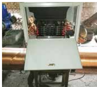
Vulcan S500主机安装在保护柜中，以防人员工作中不小心碰坏设备
