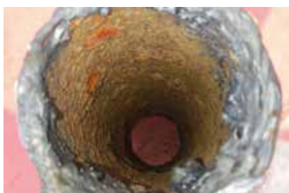
安装沃肯(Vulcan)前取样, 管内壁铁锈明显
