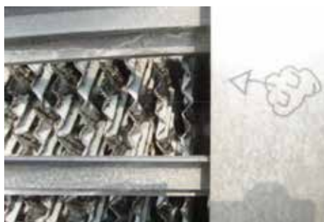
在安装沃肯(Vulcan)之前: 冷却塔外部
