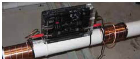
安装在泳池主管线上的Vulcan S10
