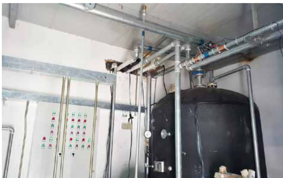
Vulcan 5000 安装在酒店进水总管路
