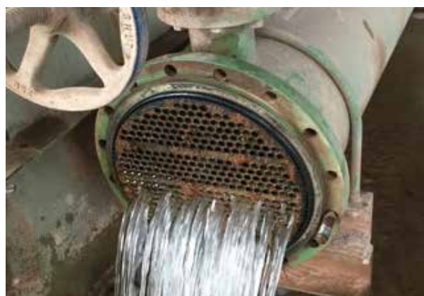
沃肯(Vuclan)安装两个月后的换热器
