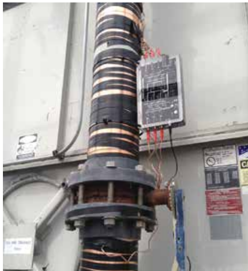
Vulcan S100 安装在冷却塔
