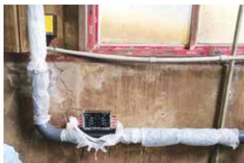
追加在污水房给污泥脱水机配套的S100
