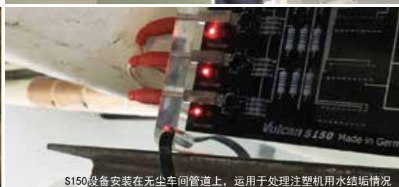
S150设备安装在无尘车间管道上，运用于处理注塑机水结垢情况
