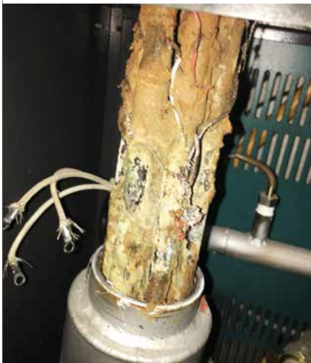
三年未作处理的换热器结垢情况
