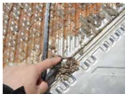
板式换热器上的水垢变软
