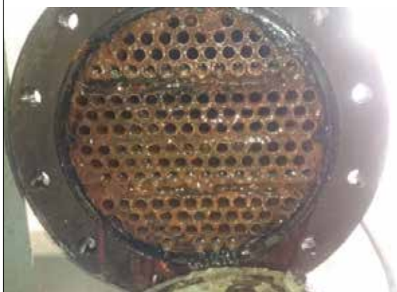
沃肯(Vuclan)安装前的换热器
