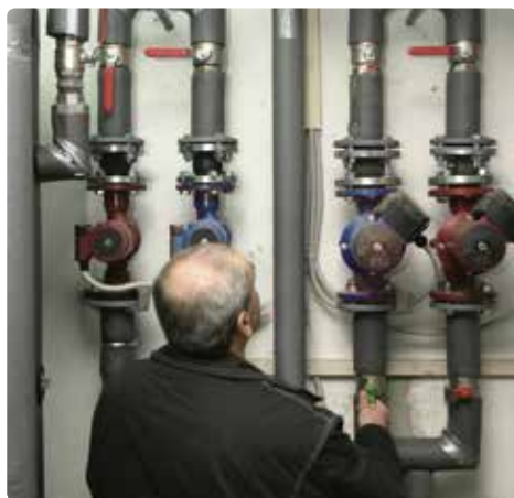
公寓大楼中的管道系统
